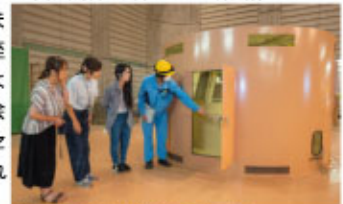
水車の真上に位置する発電機
